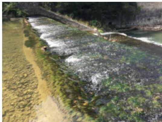
Figure 3 : Vue de la dalle béton supérieure du seuil qui devra être démolie partiellement
