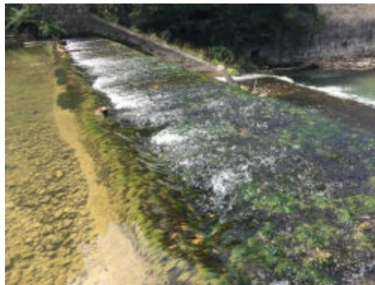
Figure 4 : Vue de la dalle béton supérieure du seuil qui devra être démolie partiellement
