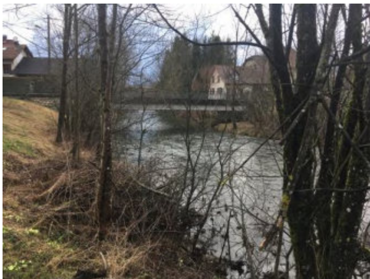
Figure 44 : Vue depuis l'amont du Pont Jean Lioud en rive gauche (emplacement de la rampe d'accès)
